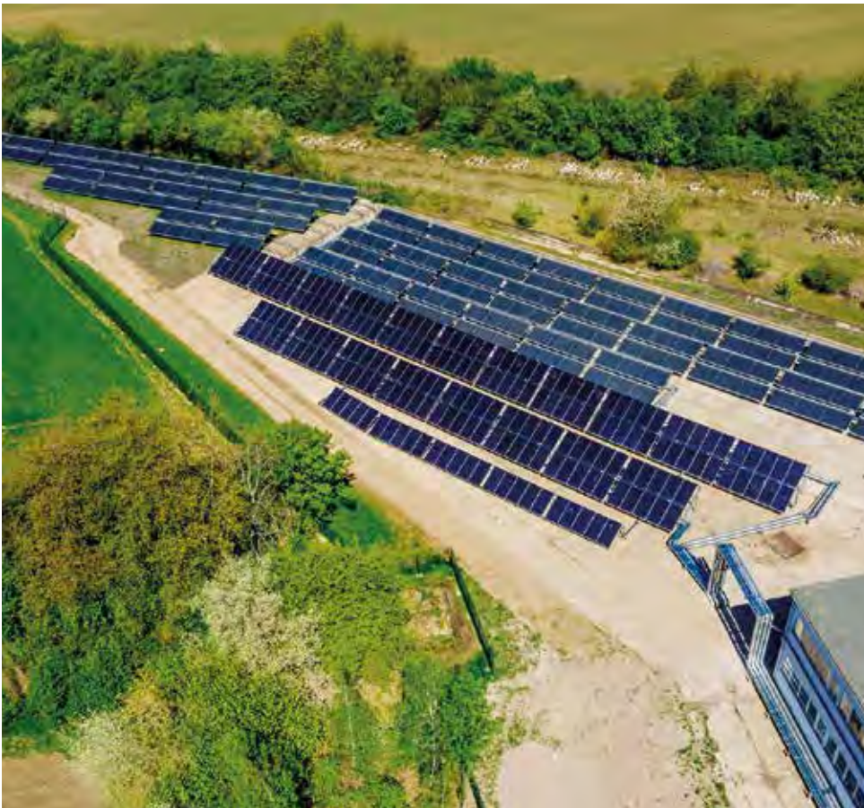
Thüringens größte Solarthermieanlage in Erfurt Marbach gewinnt Wärme aus der Energie der Sonne. Eingespeist in das Fernwärmenetz der Stadtwerke, trägt die Anlage aktiv zur Verringerung der klimaschädlichen CO 2 -Emissionen bei. Thuringia's largest solar thermal plant in Erfurt Marbach wins heat from the sun's energy. Fed in the district heating network of the Stadtwerke, the plant contributes actively to reduce the climate-harmful CO 2 emissions. (Foto/photo: Steve Bauerschmidt)
